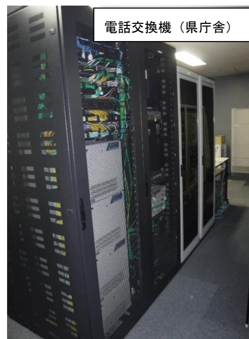
第二庁舎通信機械室（地下 2 階）
